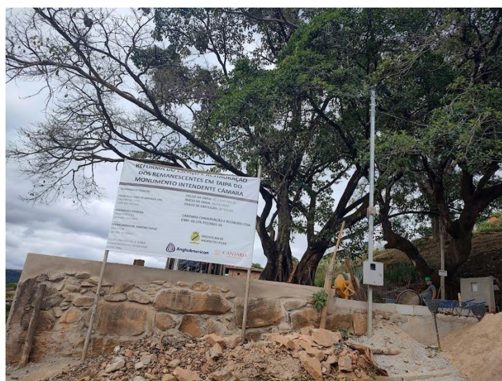
Figura 4: Ruínas da Real Fábrica de Ferro (Paredão), no Morro do Pilar durante a reforma, 2023
